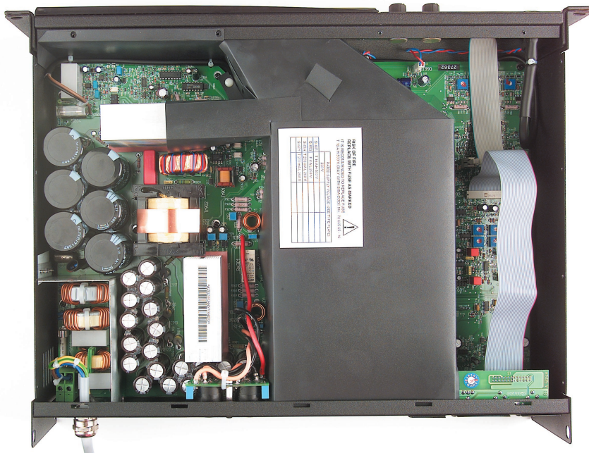
Blick in die Endstufe bei abgenommenem Bodenblech
